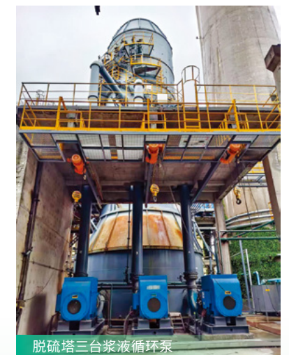
脱硫塔三台浆液循环泵
